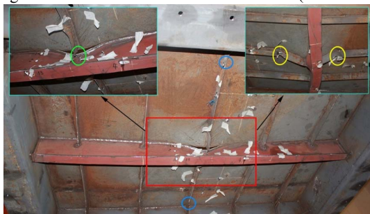
图8 板架结构破坏情况 (背面)
