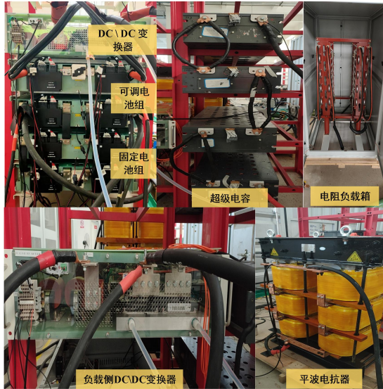
图 11 混合储能实验平台实物图
