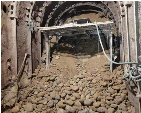
图 3 砂卵地层隧洞开挖面坍塌图
