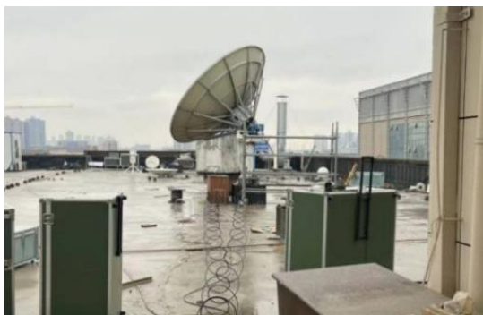
图 6 3.7m 卫星通信固定站实物图
