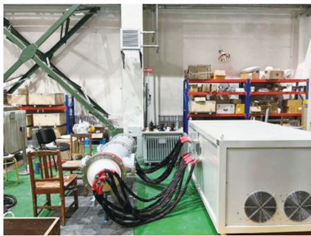
图4 温升试验样机现场
